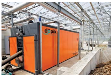
Hackschnitzelheizung mit Vorratsbunker
